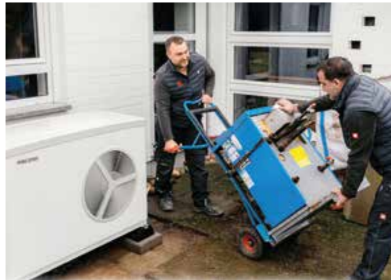
Experten aus dem Heizungshandwerk beraten zu den Möglichkeiten und übernehmen die fachgerechte Modernisierung. Foto: DJD/Stiebel Eltron
