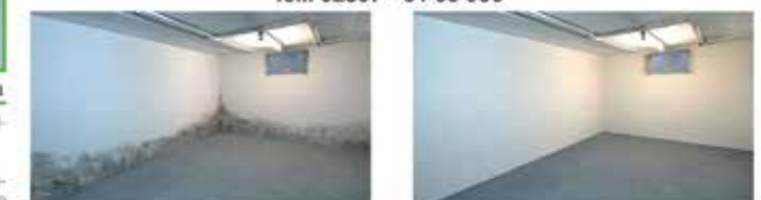
Fotos vom Fachmann: typisches Schadensbild im Keller
