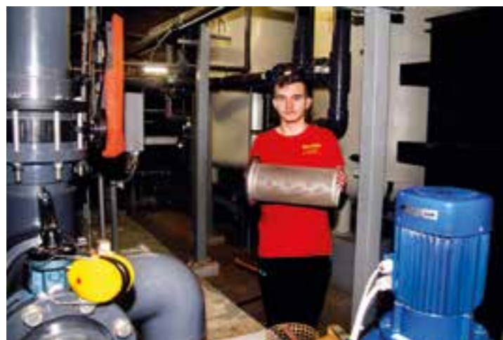
Leon Grön im Technikeller mit einem Fasernfänger. Diese Filter müssen regelmässig ausgebaut und gereinigt werden.
