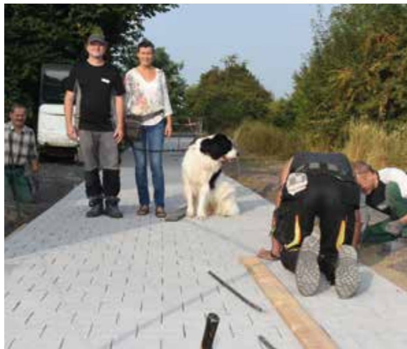
Anleiter Andreas Siebeck (Werkstatt im Kreis Unna) und Renate Nick auf der Baustelle. Foto: privat
